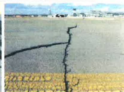
能登空港の被災（穴水町）
