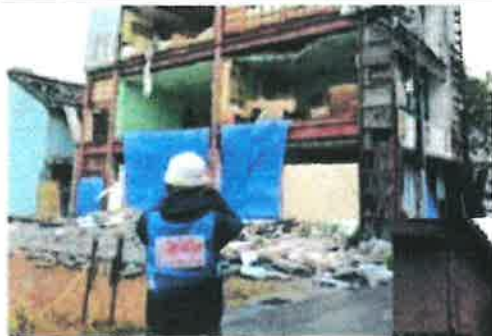
建築物の損壊状況（七尾市）
