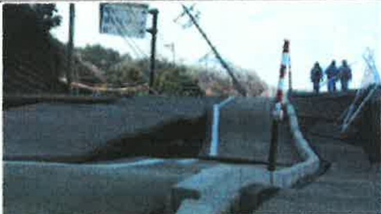
国道249号道の駅千枚田付近（輪島市）
