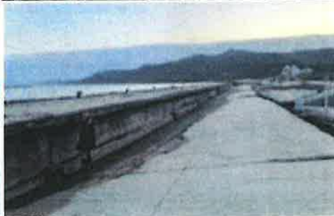
輪島港の被災（輪島市）
