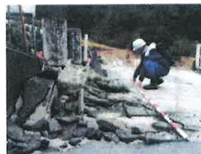
岩屋浄水場の被災（七尾市）
