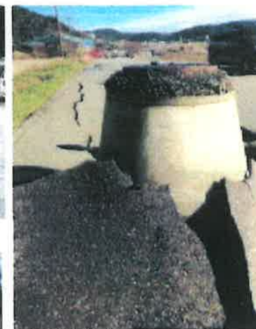
下水道マンホールの浮き上がり（輪島市）
