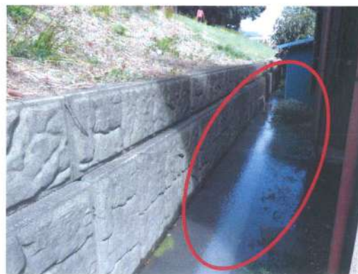
平成26年台風18号 あかつき大橋上流右岸漏水状況
